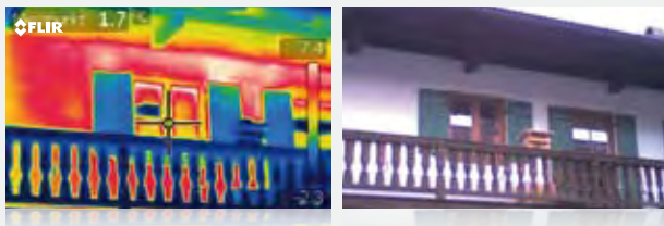
Isolamento scadente sopra la finestra del balcone
