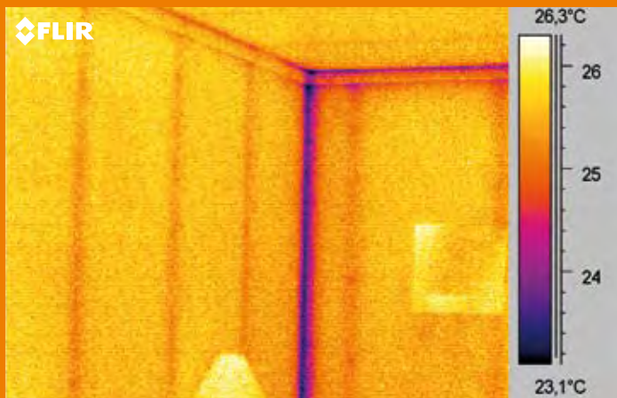
Immagine IR presa dall'interno. Si vedono la struttura e le viti inserite nei suoi pannelli di rivestimento. L'angolo è chiaramente più freddo; si tratta del cosiddetto effetto angolo, ma non c'è nulla di sbagliato.
